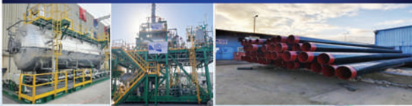
محطة معالجة المياه
